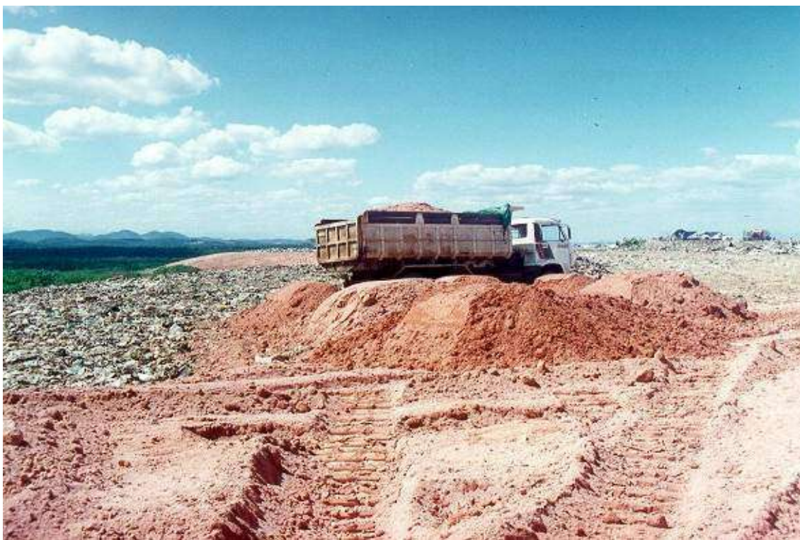
Figura 18 - Cobertura de RSU no AMJG com argila (inserir)
