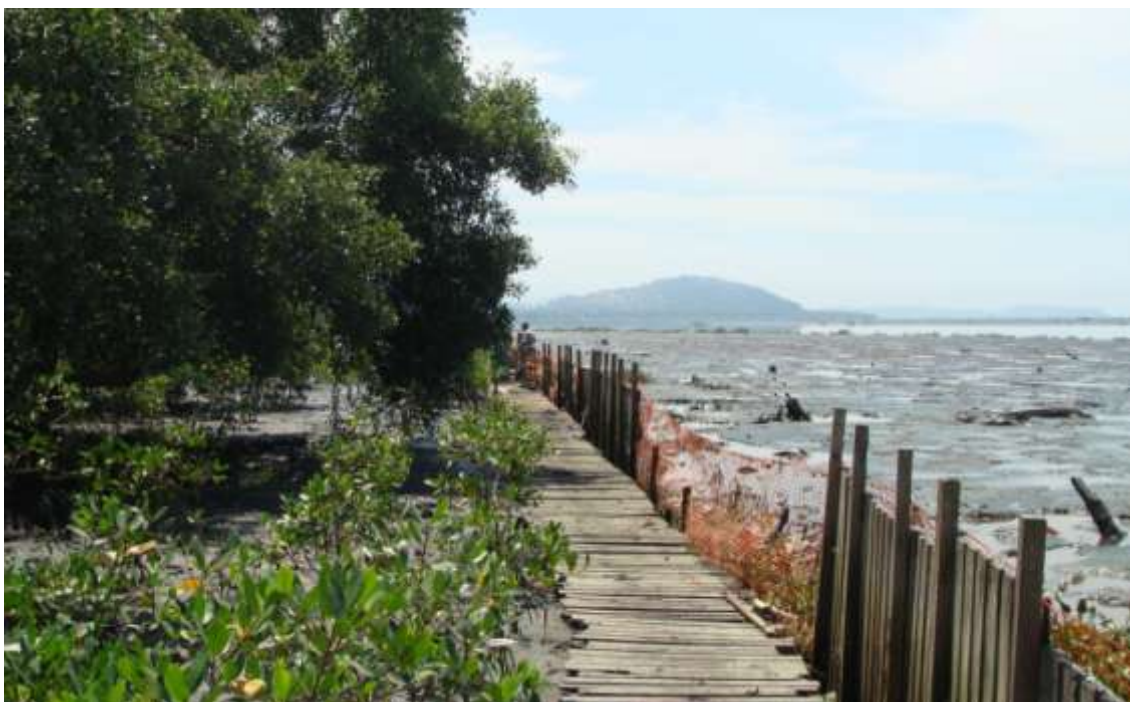
Figura 70 - Área de replantio, ao final da trilha do mangue, mostrando danos causados por ressaca à cerca de proteção contra entrada do lixo
