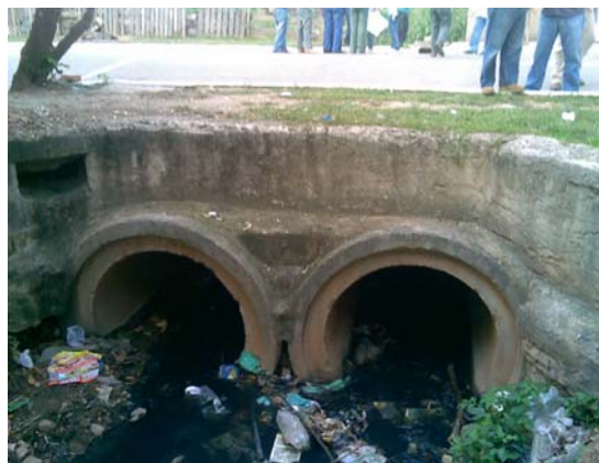
Figura 4.7 - Travessia sub-dimensionada no Valão Jaques Moley em Duque de Caxias.
