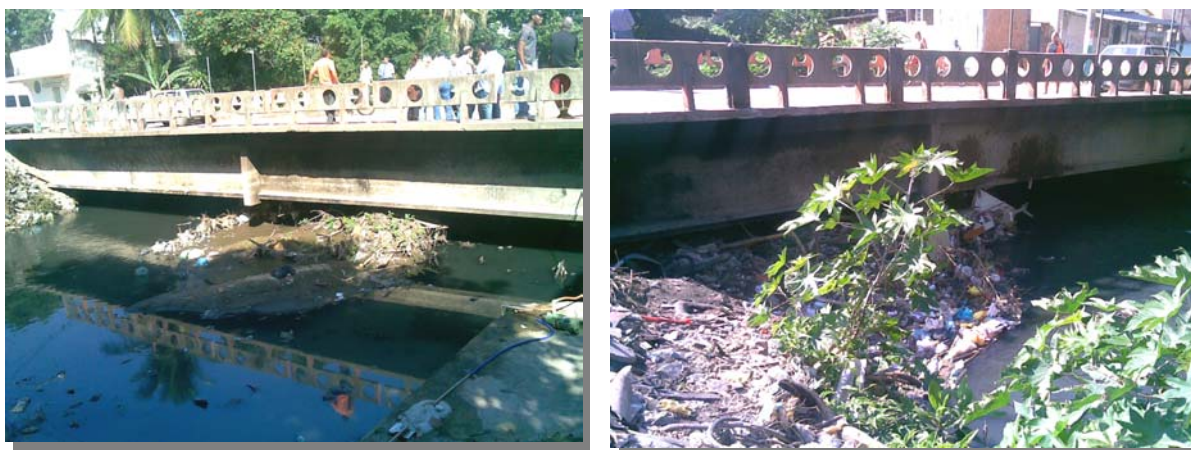
Figura 4.10 - Ponte na Rua França Leite sobre o rio Sarapuí, entre Mesquita e Nilópolis, obstruindo a calha do rio e assoreado, ocasionando remanso a montante.
