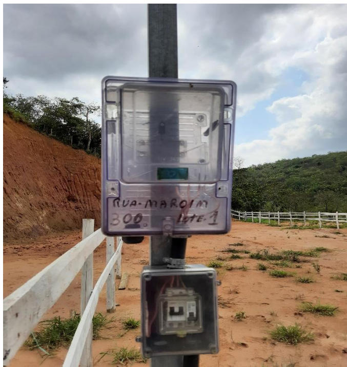
Imagem 17: Caixa de energia do “Lote 1”, no loteamento do “Polígono 3”
